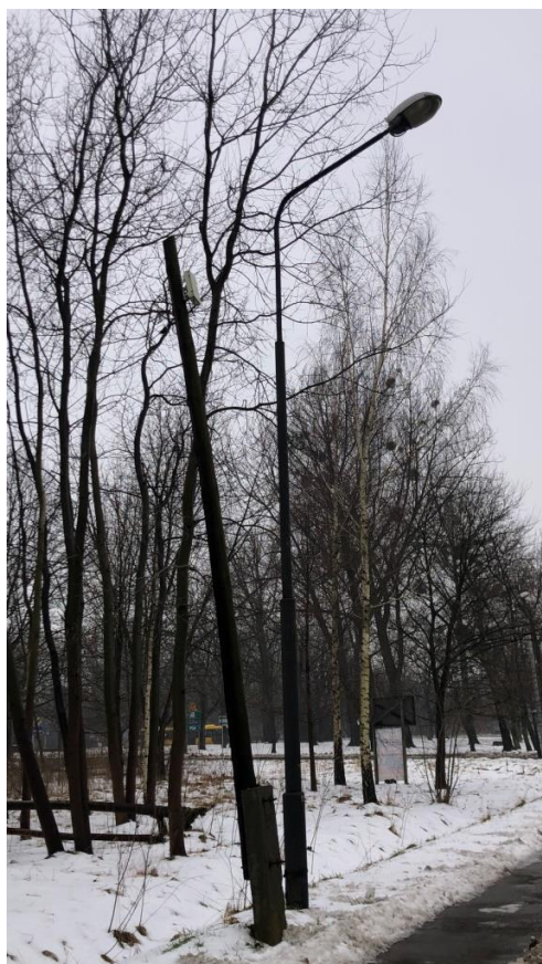
Słup nr 4 (stalowy z oprawą 9m)
