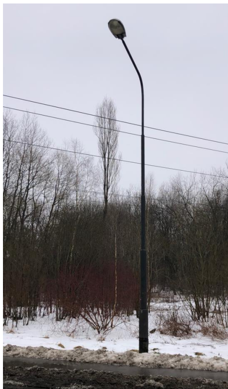
Słup nr 9 (stalowy z oprawą 9m)
