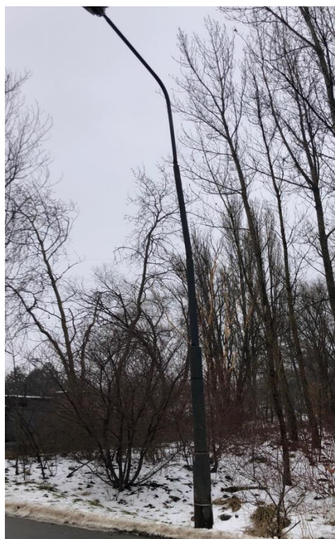
Słup nr 10 (stalowy z oprawą 9m)
