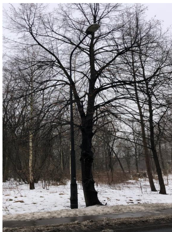
Słup nr 7 (stalowy z oprawą 9m)
