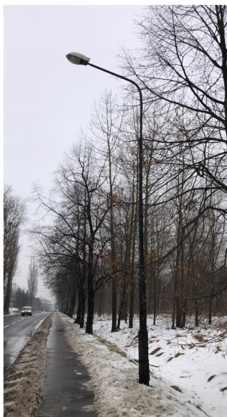
Słup nr 5 (stalowy z oprawą 9m)
