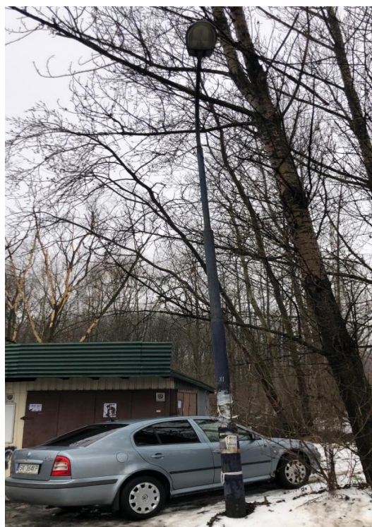
Słup nr 11 (stalowy z oprawą 9m)
