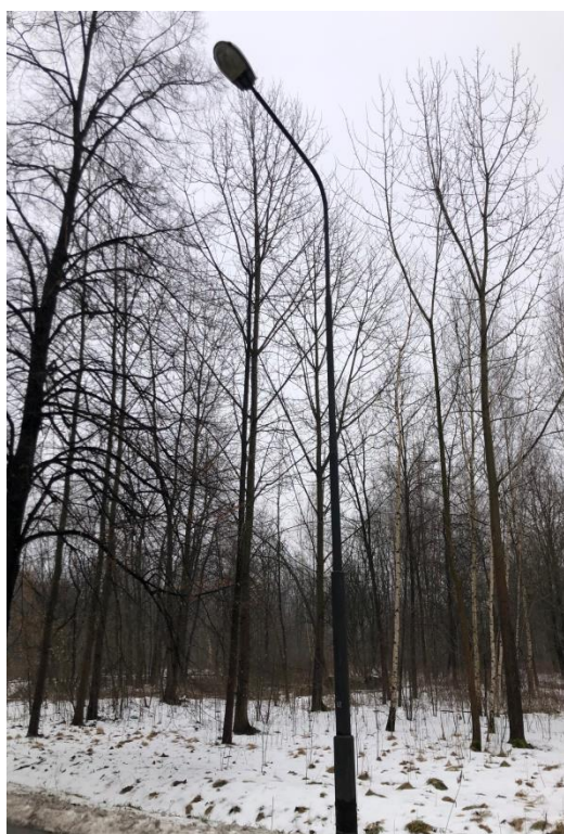
Słup nr 6 (stalowy z oprawą 9m)
