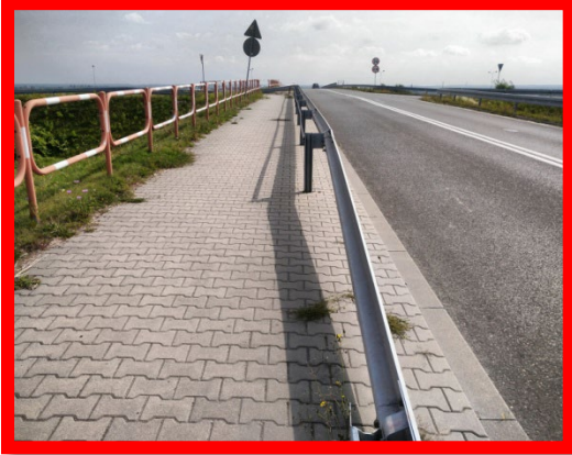
Fot. Wiadukt nad Autostradą A1 (strona lewa trasy widok w kierunku gminy Gierałtowiec).
